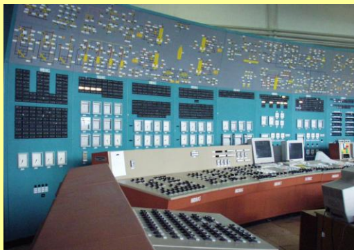
Пульт управления АЭС с системой управления верхним блочным уровнем (лаб. № 31)
