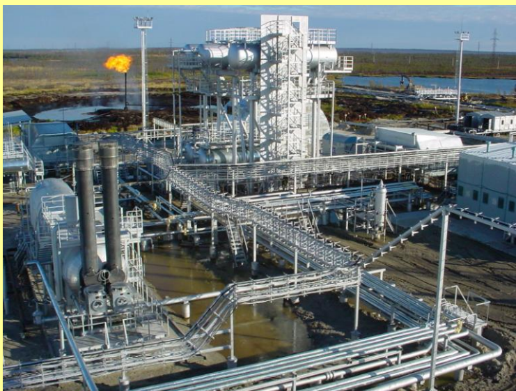
Дожимная насосная станция компании «ТНК», на которой установлена система управления, разработанная в лаб. № 3
